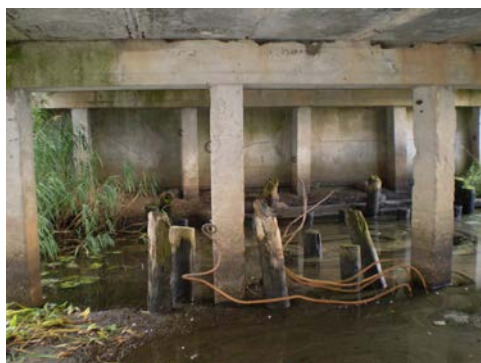
Рис. 2. Остатки деревянных свай, арматура в русле канала под мостом на автодороге Н-3900 Буки – Мосар, км 7,32 (август 2008 г.)
