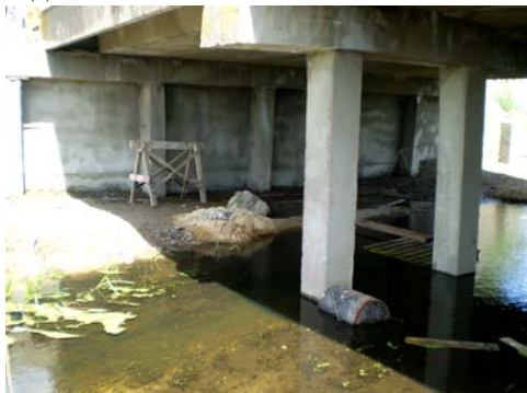
Рис. 1. Строительный мусор в русле р. Ведрич под мостом на автодороге Н-4162 Речица – Горваль – Василевичи, км 70,061 (июнь 2008 г.)
