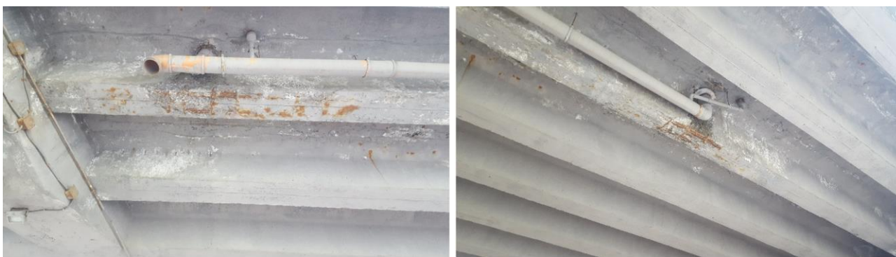
Рисунок 1 – Водоотвод, коррозия арматуры
