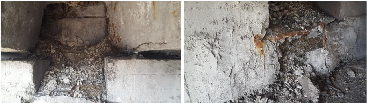
Рисунок 3 – Разрушение узла опирания балки
