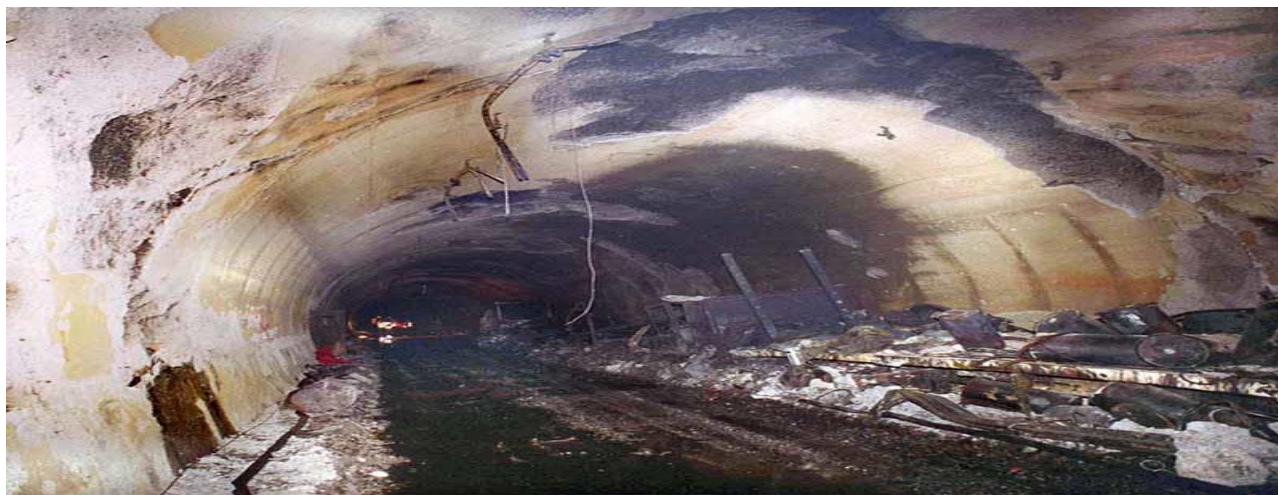
Рисунок 1 – Тоннель Монблан после пожара
