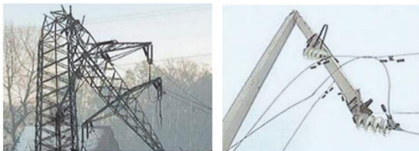
Рис. 3. Гололёд – бедствие для линий электропередач
