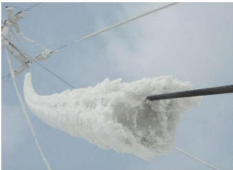
Рис. 2. Характерное обледенение провода ЛЭП
