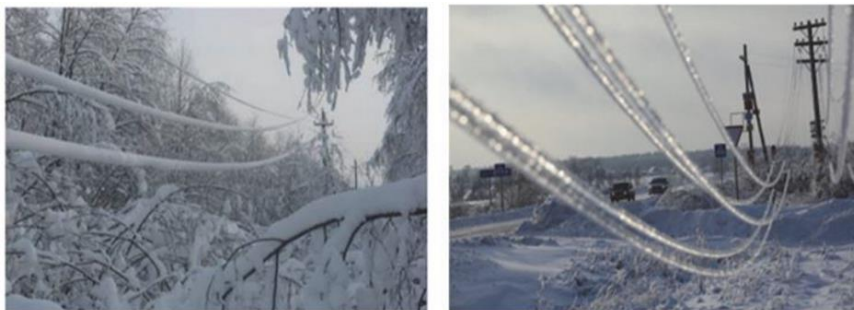
Рис. 1. Гололедные отложения на проводах воздушной линии электропередач
