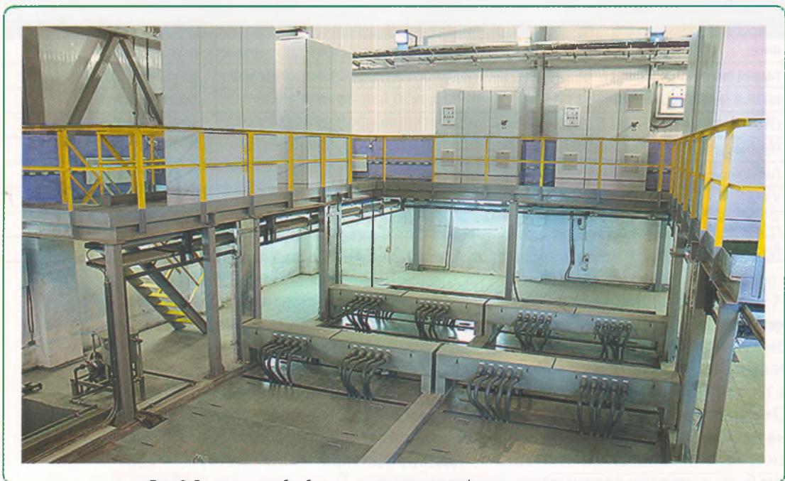
Рис. 2. Вид станции обработки сточных вод ультрафиолетовым излучением
