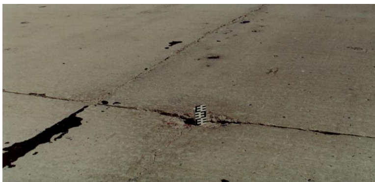
Рис. 10.19. Повреждение кромок швов
