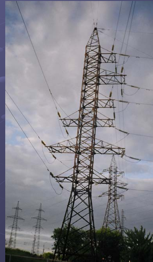
Металлическая ответвительная опора 110 кВ
