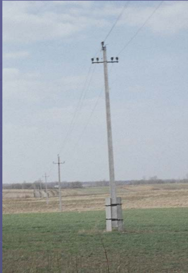
Железобетонная опора 10 кВ
