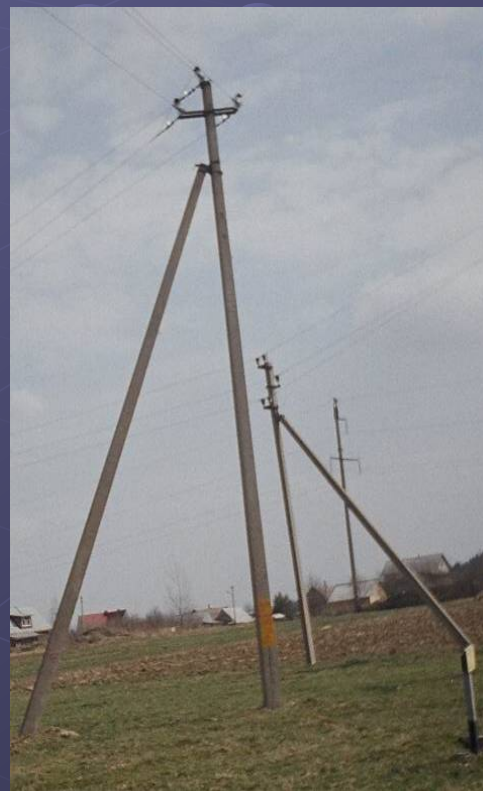
Железобетонные опоры 10 кВ
