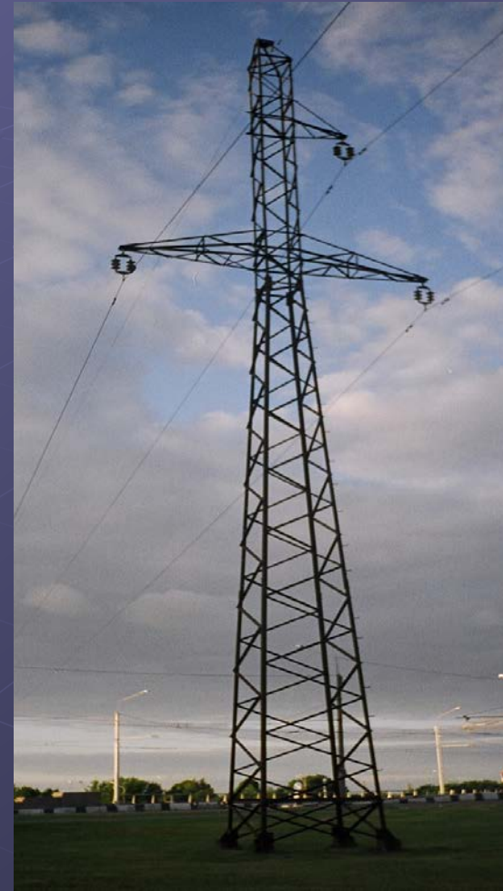
Металлическая опора 110 кВ
