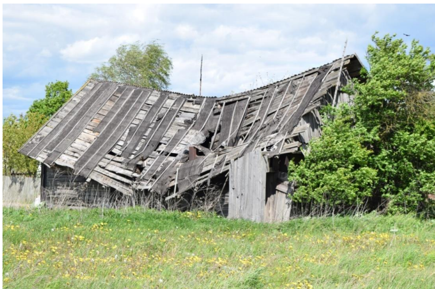
Рис. 1.2 – Просадка деревянного дома в д. Метявичи
