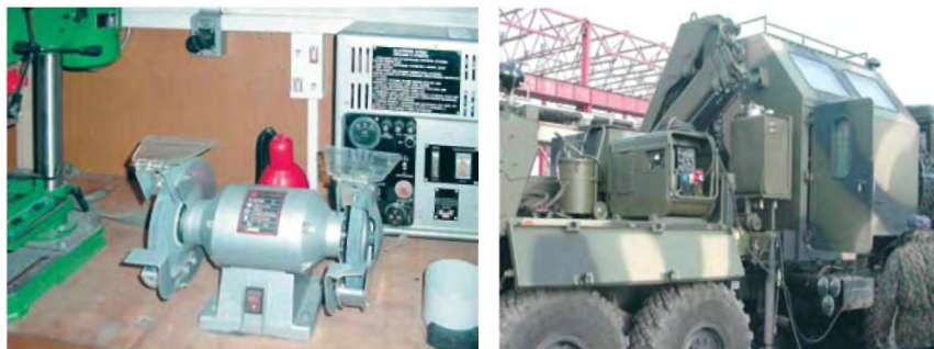
Рис. 3.11. Расположение основного оборудования в кузове-фургоне ВЭМ-К
