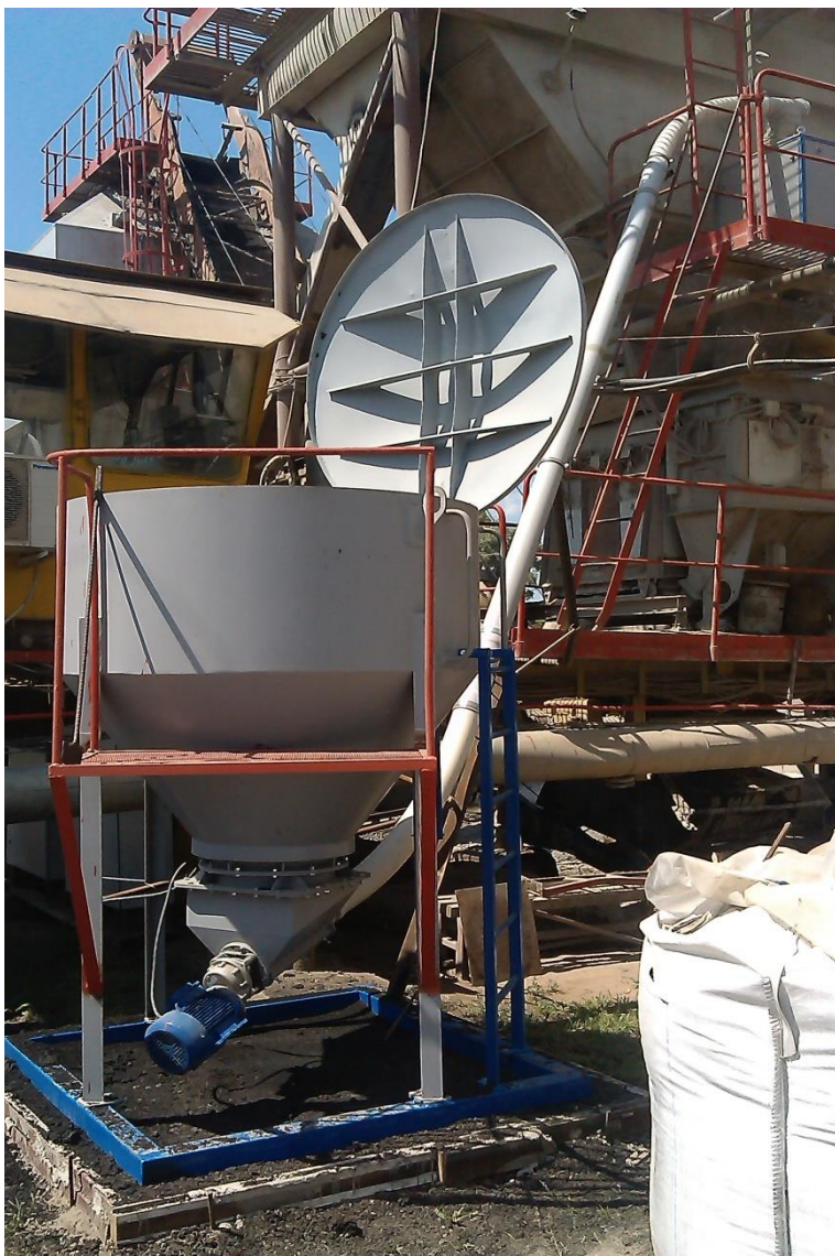
Рис. 4 – Подача РБВ-Г по стандартной линии подачи целлюлозы
