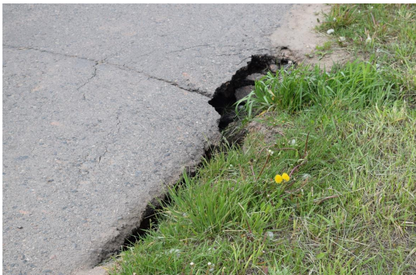
Рис. 1.3 – Разлом и просадка дорожного полотна на ст. Калий – III.
