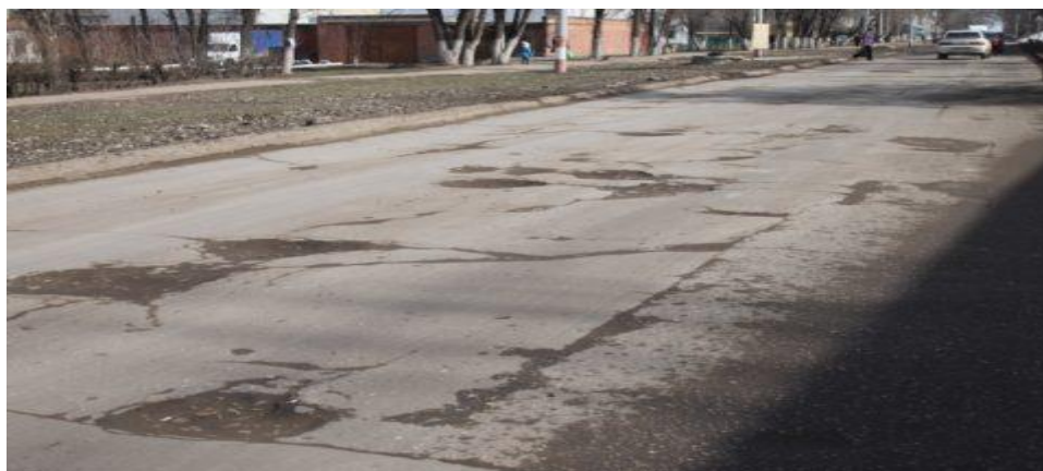
Рисунок 1 – Деформация автомобильной дороги
