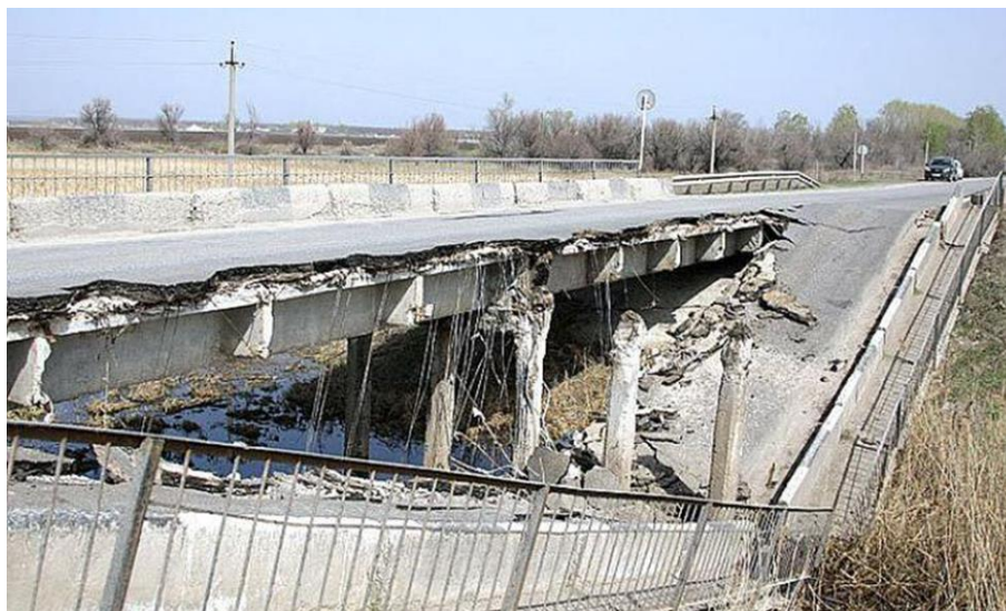
Рисунок 3 – Обрушение моста на дороге Р-225 «Самара – Бугуруслан»
