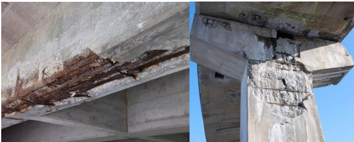
Рисунок 1 – Коррозия арматуры балки пролетного строения и опоры
