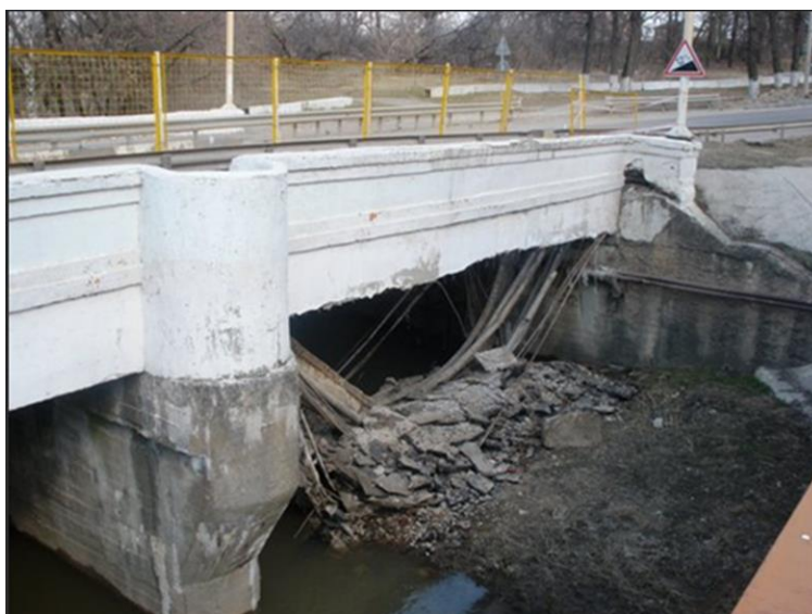
Рисунок 2 – Обрушение моста через реку Чалвенка
