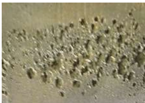
Рисунок 3 – Эрозионный износ стенки корпуса теплообменного аппарата
