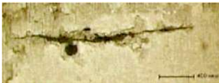
Рисунок 4. Коррозионная трещина трубки поверхности нагрева
