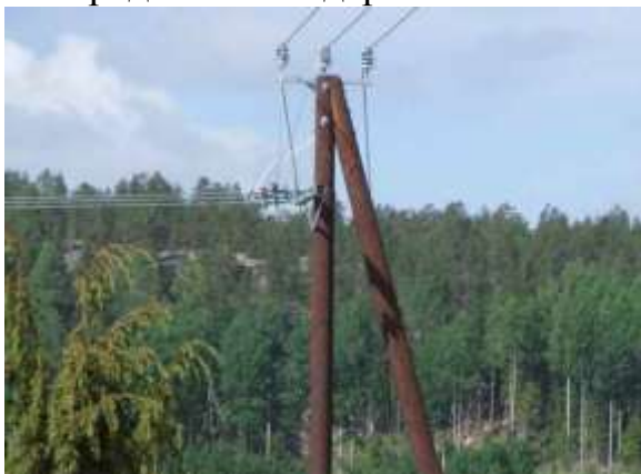
Рисунок 1. Деревянная опора ВЛ-10 кВ
