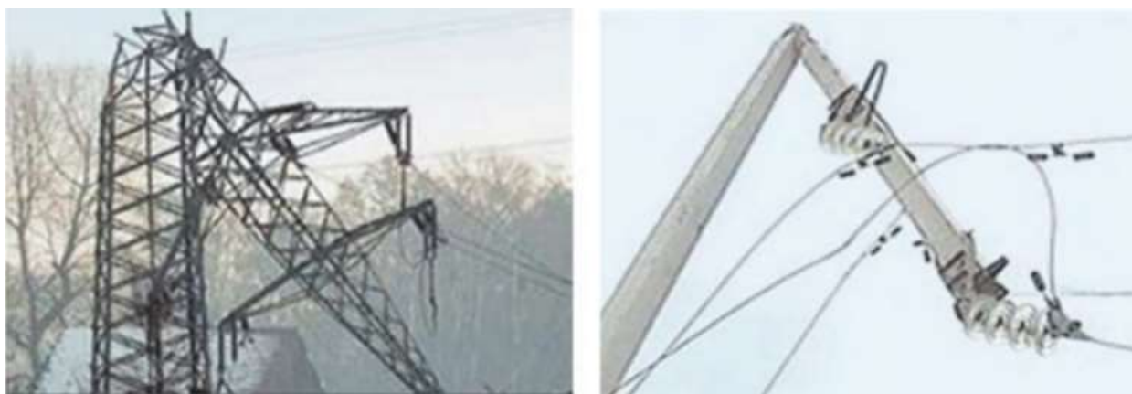
Рисунок 2. Гололёд – бедствие для линий электропередач
