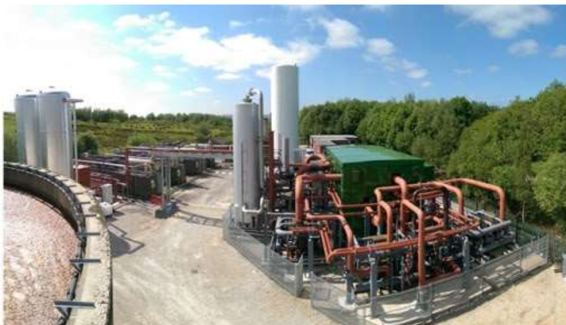
Рисунок 3 Криогенная аккумулирующая электростанция. Англия
