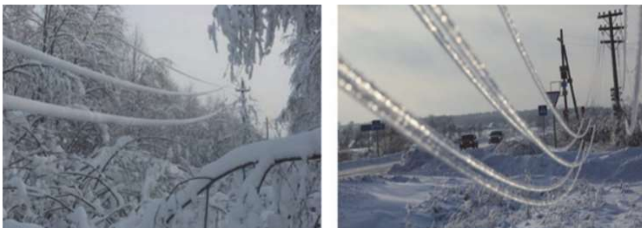
Рисунок 1. Гололедные отложения на проводах воздушной линии электропередач
