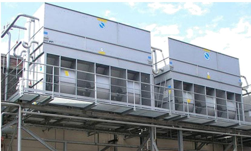
Рисунок 2. Конденсаторы водяного охлаждения холодильного склада
