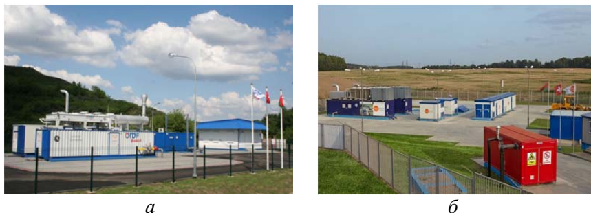
Рис. 2.179. Общий вид оборудования для использования в энергетических целях свалочного (а) полигон Тростенц (3 мВт); (б) Северный (5,8 мВт)
