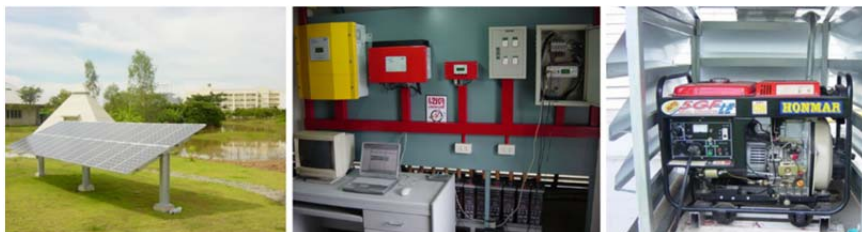
Рис. 2.192. Гибридная система на основе фотоэлектрических батарей (75 Вт × 16) и дизель-генератора Honda 5GFLE, 5 кВт
