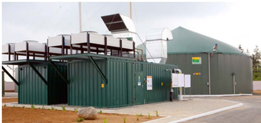
Рис. 2.174. Схема и общий вид биогазовой установки (Заславская птицефабрика, электрическая мощность – 300 кВт)
