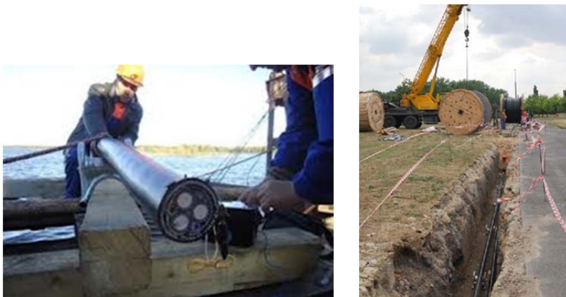
Рис. 1.43. Общий вид и прокладка кабельных линий электропередач
