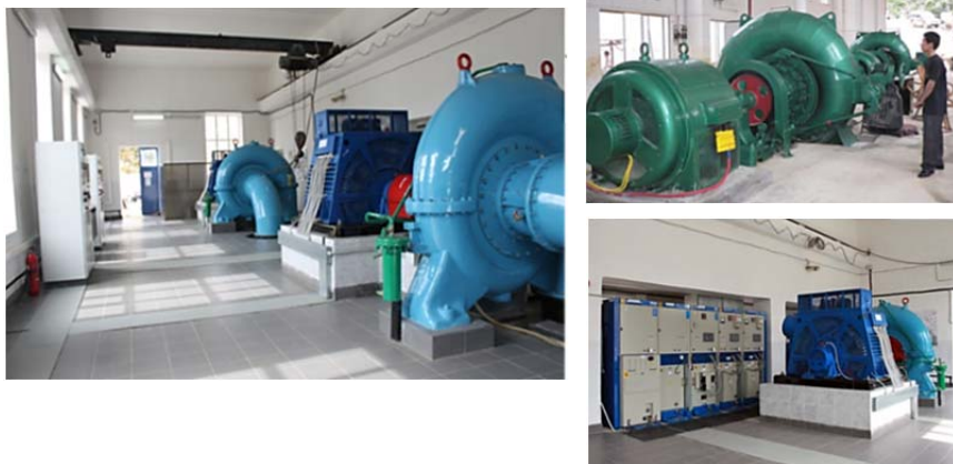
Рис. 2.154. Общий вид генераторного оборудования малых ГЭС
