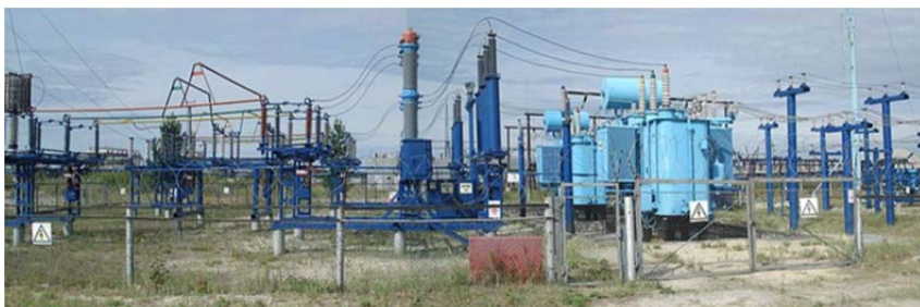
Рис. 1.44. Общий вид оборудования подстанций различной мощности
