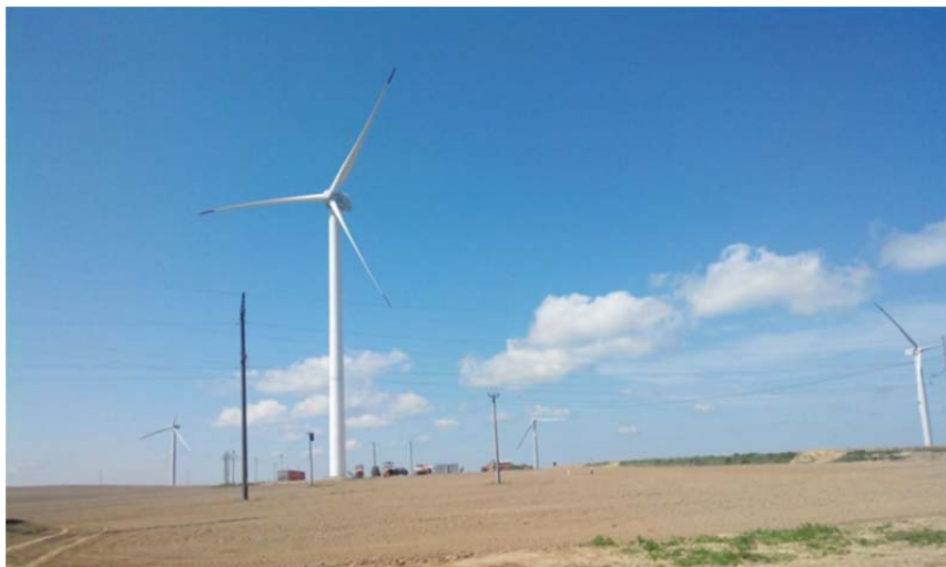
Рис. 2.85. Общий вид первого в Республике Беларусь ветропарка мощностью 9 МВт
