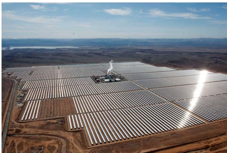
Рис. 2.46. Общий вид самой крупной солнечной электростанции (Марокко)
