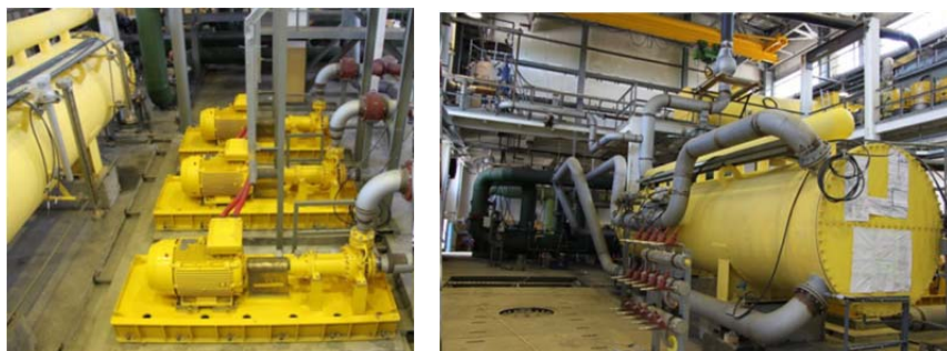
Рис. 2.97. Общий вид оборудования бинарного блока ГеоТЭС
