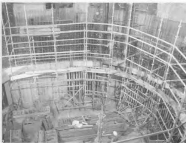
Рис. 6. Установка опалубки и армирование основной (прижимной) стенки и дна магазина сменных арен
