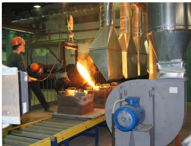
Рисунок 1 – Организация вентиляции в производственном цеху Источник: [2]
