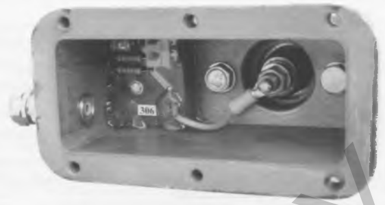
Рис. 6. Датчик ДВ-2, установленный на ввод
