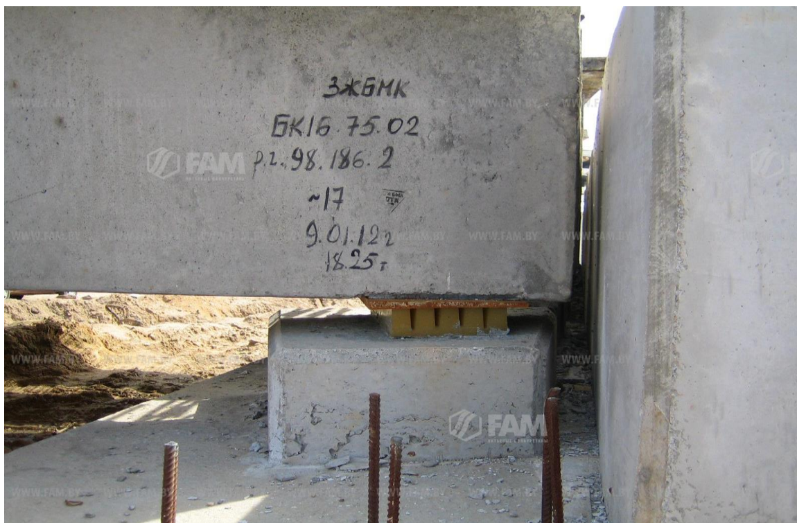
Рисунок 2 – Опорная часть из полиуретана в процессе эксплуатации
