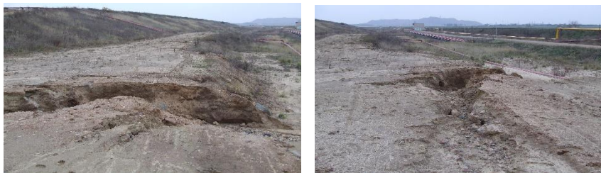
Рис. 3. Деформации откосов ограждающей дамбы шламохранилища
