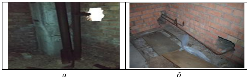
Рис. 3. Вид ответвления № 20: а – с коррозионными повреждениями, б – санузла второго этажа
