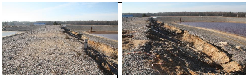
Рис. 4. Деформация крепления откоса разделительной дамбы, секция № 1
