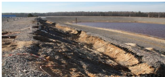
Рис. 1. Деформации верхних откосов ограждающей дамбы
