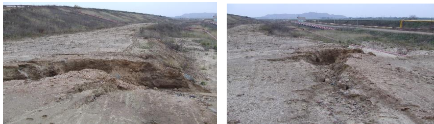
Рис. 3. Деформации откосов ограждающей дамбы шламохранилища
