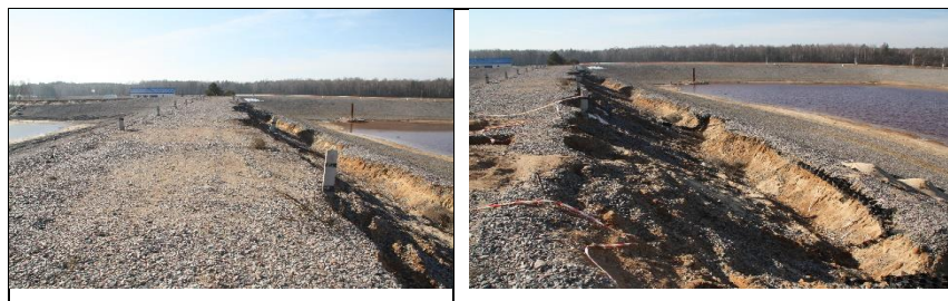
Рис. 4. Деформация крепления откоса разделительной дамбы, секция № 1
