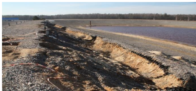
Рис. 1. Деформации верхних откосов ограждающей дамбы
