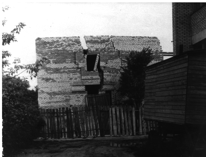
Рис. 37. Разрушение здания «Беларусбанка» в г. Шарковщина на склоне возле реки вследствие оползня, активизировавшегося при динамических воздействиях от забивки свай и разжижении ила в их основании
