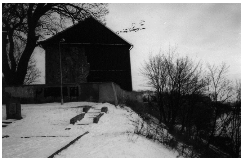
Рис. 39. Здание Каложской церкви в г. Гродно на склоне у р. Нёман, часть которой обрушилась при подмыве и активизации оползневого процесса
