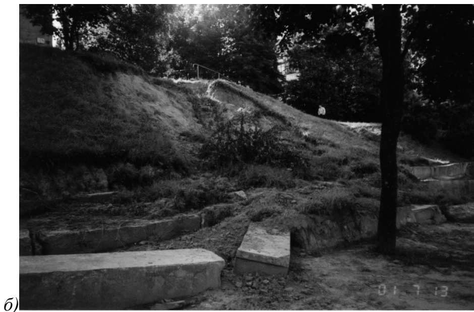
Рис. 20 Образование промоин на откосе при струйчатой эрозии (а) и оврага на склоне за подпорной стеной на ул. Жудро в Минске (б) при нарушении одерновки
