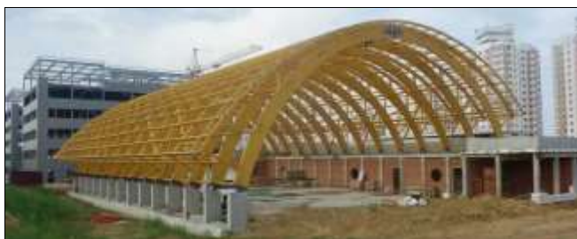
Рис. 8. Общий вид в стадии монтажа арочного покрытия физкультурно-оздоровительного центра Парка высоких технологий
