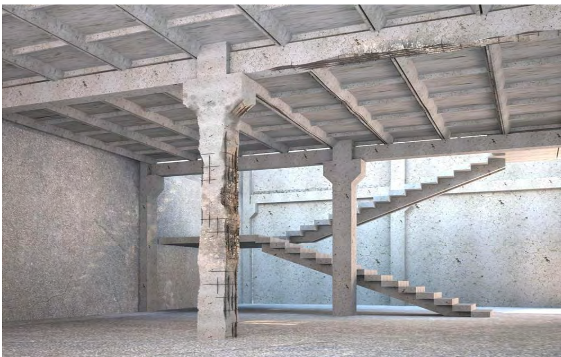
Рисунок 1 – Разрушение железобетонных конструкций
