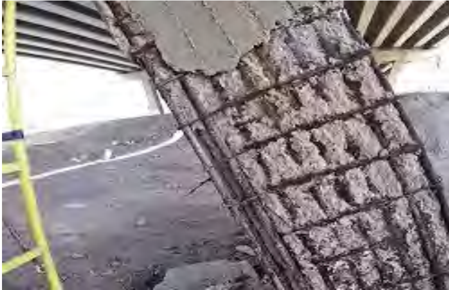
Рисунок 1 – Коррозионные повреждения бетонной опоры моста
