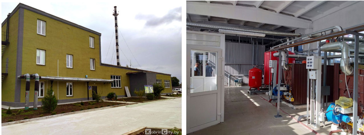
Рисунок 1 – Реконструированная котельная в Дивине: слева – вид снаружи; справа – вид внутри котельной
