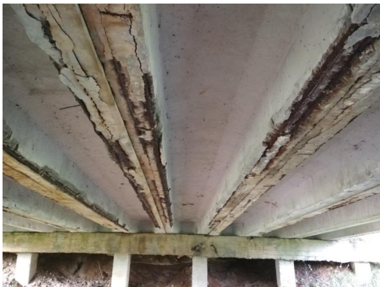
Рис. 1. Разрушение бетона и коррозия арматуры
