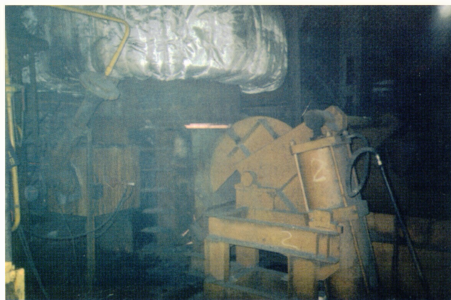
Фото 3. Оборудование завалочного окна на модернизированной вагранке: автоматизированный узел дожигания, опрокидывающийся лоток с пневмоприводом, завалочное окно, перекрытое качающейся шторкой, коллектор отбора горячего дутьевого воздуха от рекуператора
