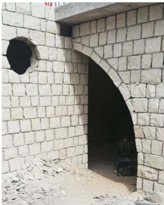
Рис. 2. Фрагмент стены. Реконструкция жилого дома с приспособлением под гостиницу в г. Аль-Марвания
