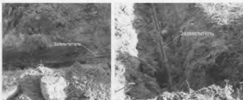
Рис. 8. Примеры прокладки заземлителей на малой глубине (заземлители проложены на глубине не более 0,2 м)
