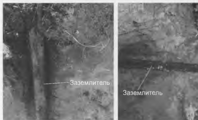
Рис. 7. Пример коррозионного износа заземлителей (заземлители с элементами коррозии)
