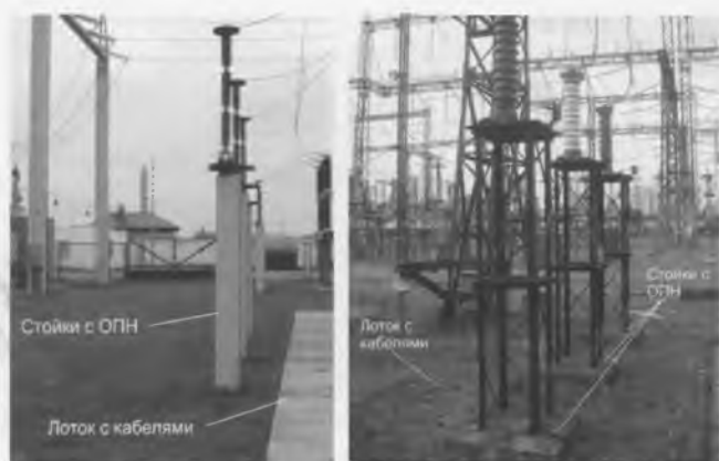
Рис. 4. Примеры несоблюдения допустимых расстояний от заземлителей ОПН и разрядников до кабелей вторичных цепей (устройства для ограничения перенапряжений и кабельные лотки расположены в непосредственной близости)
