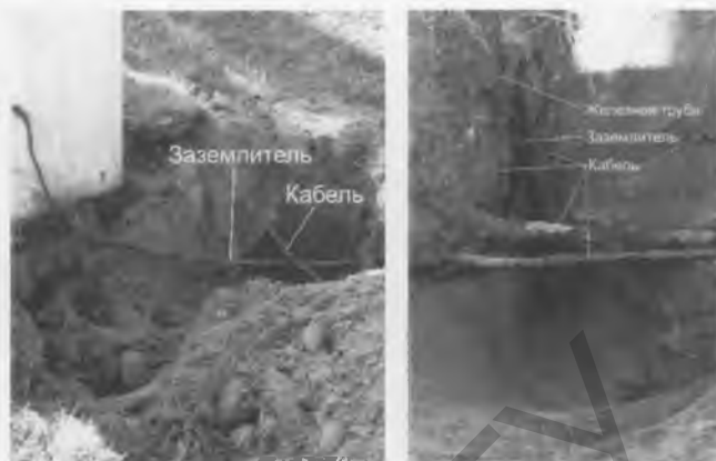
Рис. 3. Примеры несоблюдения допустимых расстояний от заземлителей молниеотводов до кабелей вторичных цепей (заземлители молниеотводов проложены в непосредственной близости от кабелей вторичных цепей)
