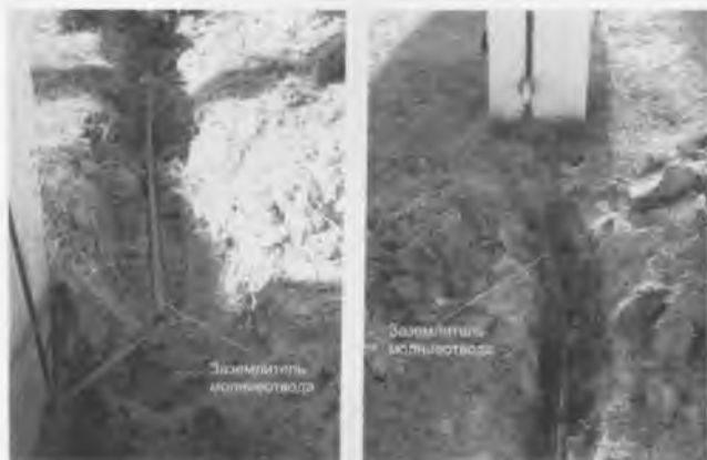
Рис. 2. Примеры неправильного исполнения заземлителей молниеотводов (заземлители молниеотводов не соответствуют требованиям по конфигурации и глубине прокладки)
