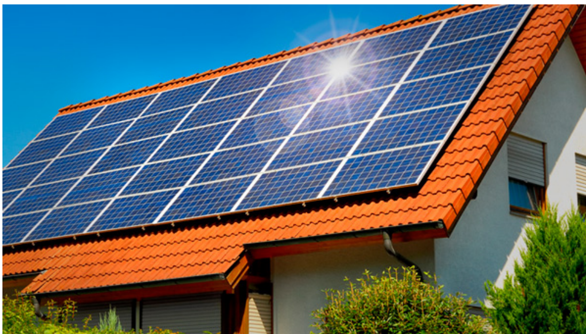
Рисунок 1.5. – Электрические солнечные фотопреобразователи (солнечные батареи) на крыше жилого дома
