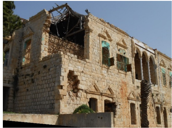
Рис. 1. Разрушения жилого дома 1905 г. строительства в г. Адайси. 2006 г.
