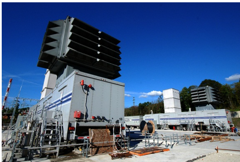
Рисунок. 1 – Мобильная газотурбинная электрическая станция
