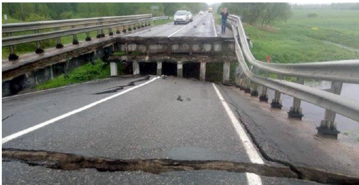
Рисунок 1 – Обрушение моста в районе деревни Новосёлки
