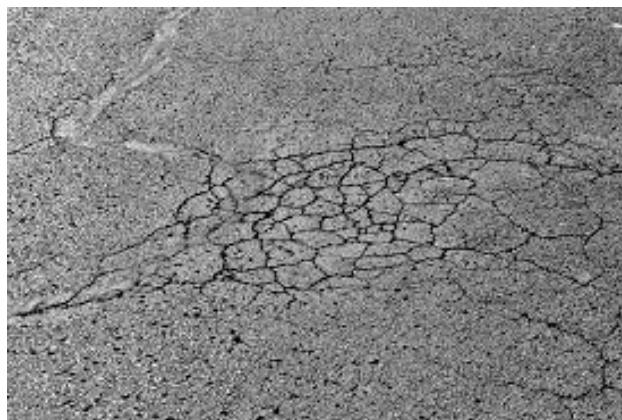
Рисунок 21 – Асфальтобетонное покрытие на участке образования пучин
