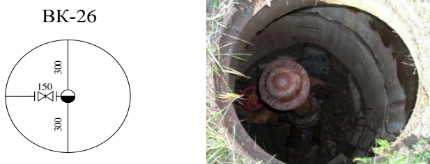
Рис. 6. Водопроводный колодец ВК-26
