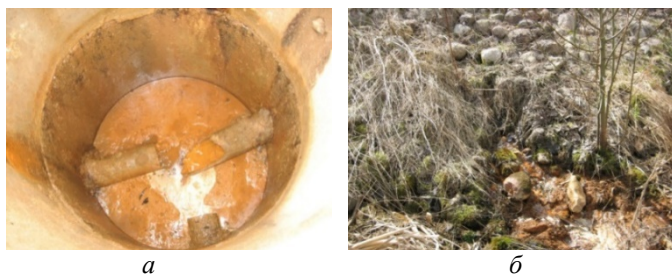
Рис. 1. ГЭС «Алешино»: a – дефекты трубчатого дренажа; б – выход фильтрационного потока на низовой откос плотины
