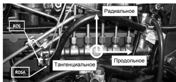
Рис. 2. Установка вибрационных датчиков на аккумулятор топлива
