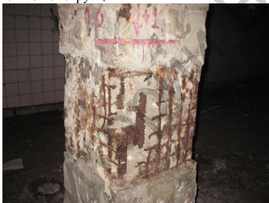
Рисунок 1. Фрагмент коррозии железобетонной колонны
