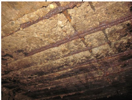
Рисунок 2. Фрагмент железобетонной плиты перекрытия (отслаивание и разрушение защитного слоя)
