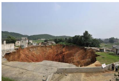
Рис. 4. Самые глобальные и частые проседания грунта наблюдаются в Китае. Провал в провинции Хунань Ø 150 м глубиной 50 м
