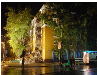
Рис. 2. При просадке грунта 24.08.2012г. г. обрушился подъезд 5-этажного дома в г. Северодвинске. Осадка фундамента по данным замеров составила 12-13 мм
